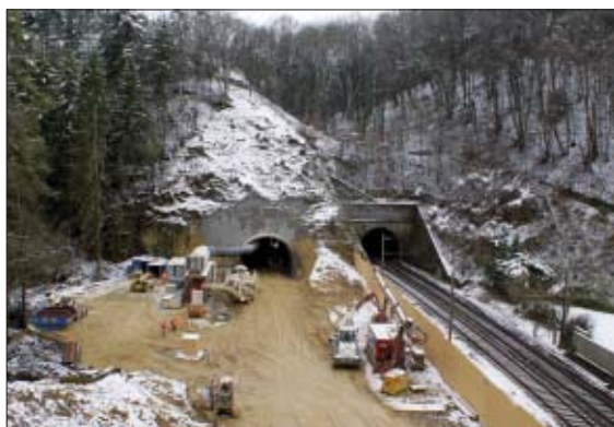
Vue plongeante sur les portails nord des tunnels sud depuis le tronçon à ciel ouvert d'Enteroches.
