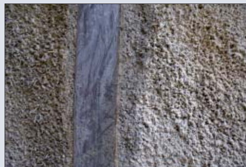
Détail de gunitage contenant des fibres synthétiques avec cintre de soutènement métallique.
