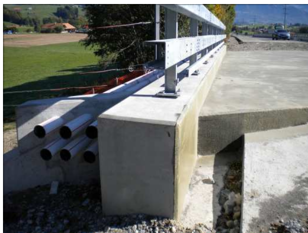
Batterie de tubes EM fixée à l'extérieur du passage inférieur
