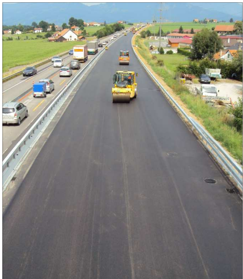
Pose du revêtement sur la chaussée côté Alpes (Trafic dans les deux sens sur chaussée Jura)
